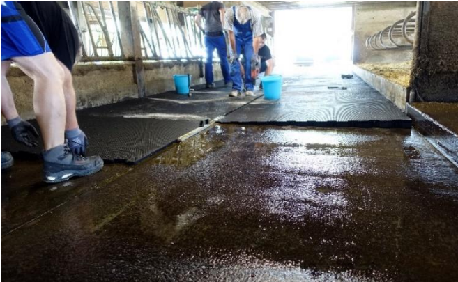
Verlegen von Gummimatten mit Quergefälle im Stall des BBZN Hohenrain. Bild: M. Bucheli
