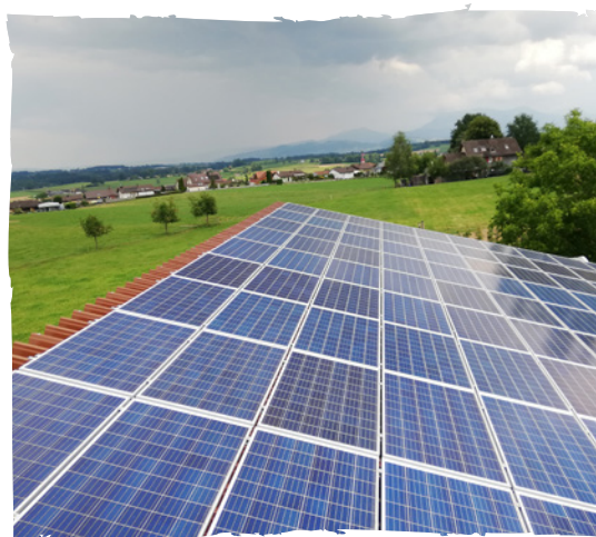
PV-Dach auf dem Hof Holderhus in Neuenkirch.
