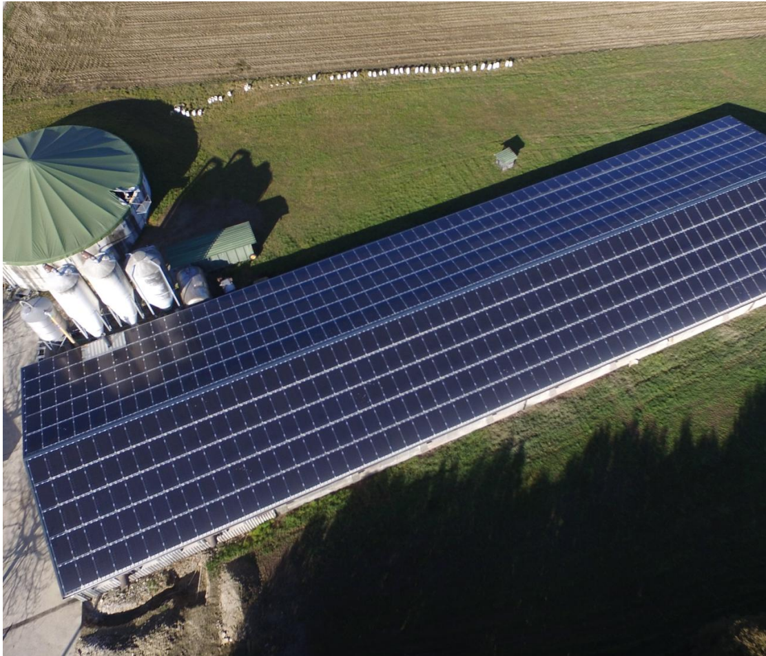
PV-Anlage auf Schweinestall
