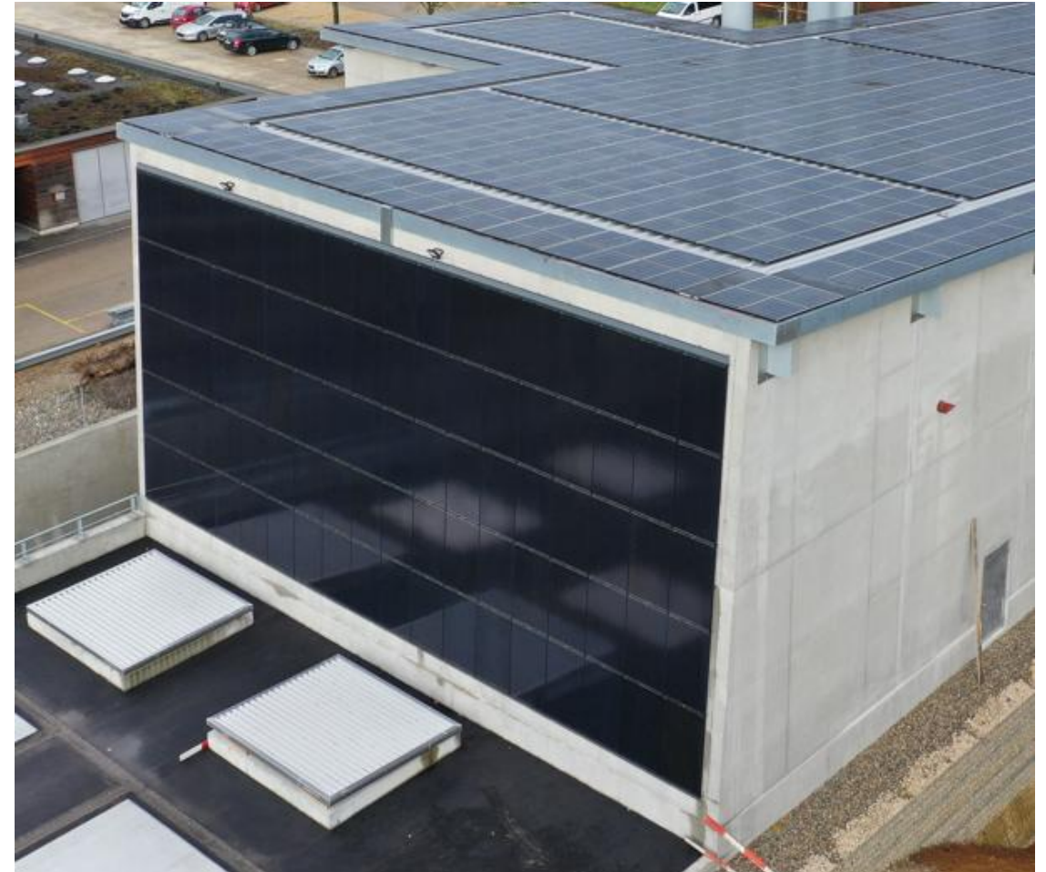
PV-Anlage auf Fassade und Dach Heizzentrale
