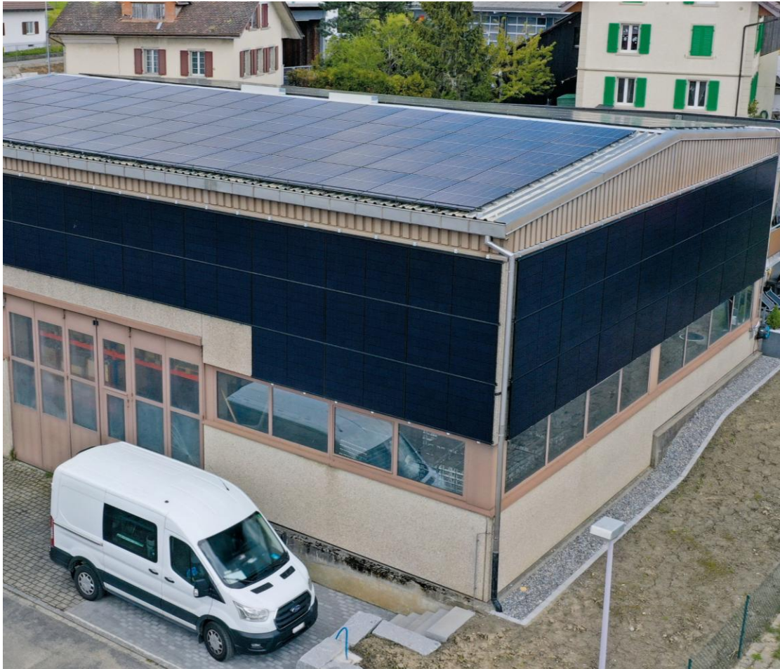
PV-Anlage auf Fassade und Dach Lagerhalle
